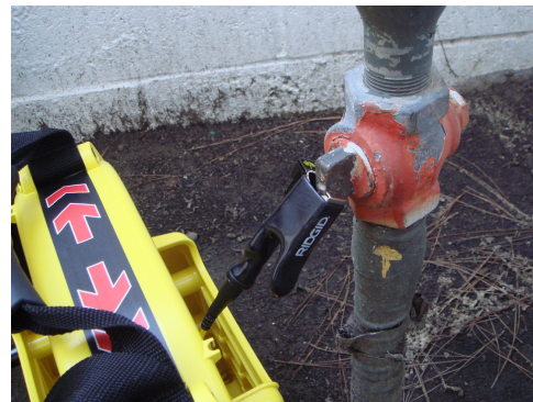
Рисунок 7 – Подводящий провод, подсоединенный к определяемому проводнику
