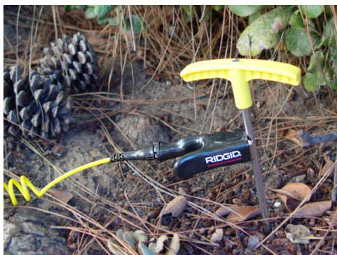
Figure 6 – Câble attaché au piquet de mise à la terre
