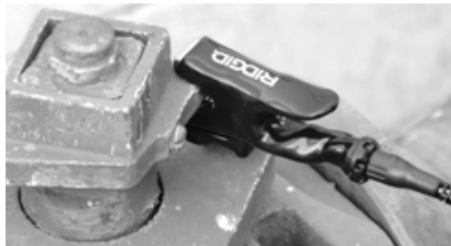
Figura 8 - Conectarea bornei cablului la conductorul țintă.
