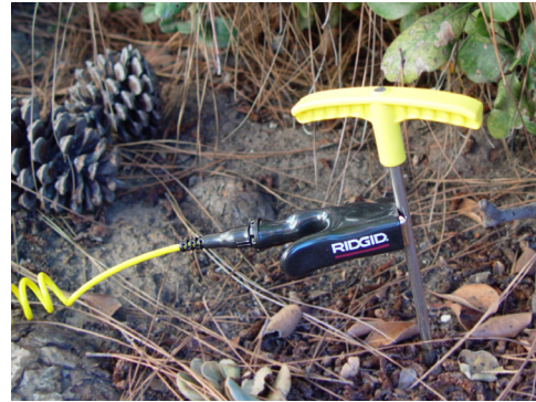
Figur 6 – Ledningsklemme koblet til jordingsstaken
