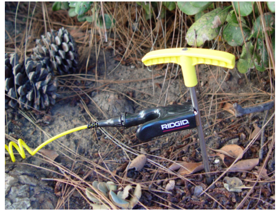
Figure 10 – Attacher le câble du ST-33Q au piquet de mise à la terre.
